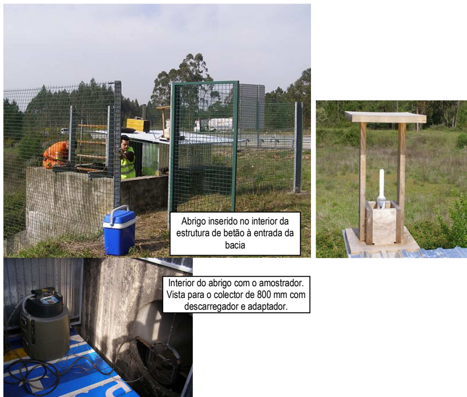
Figura 3 – Instalação de monitorização e abrigo com o equipamento em Março de 2009.
