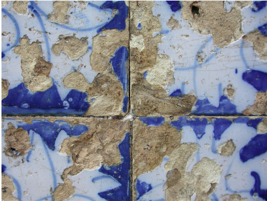
Figura 17- Patologia em azulejos de fachada de que resulta a queda do vidro
