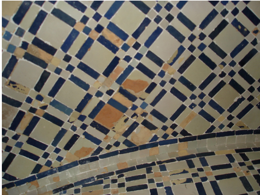
Figura 4- Pormenor de uma área de um painel em perda
