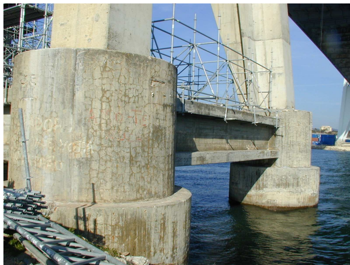
Figure 1 - Fissuration multidirectionnelle localisée sur un massif de fondation de pile de pont.
