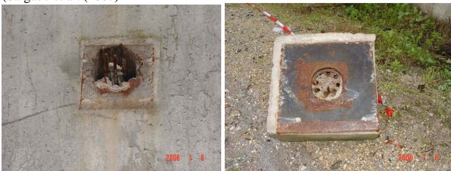
Figura 9 – a) Zona de uma das Ancoragens Sem Cabeça; b) Cabeça Caída no Chão
