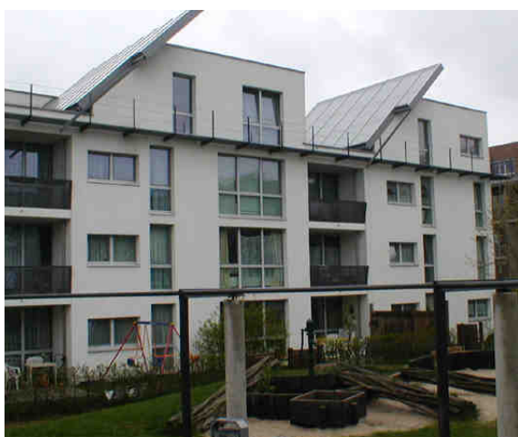
Figura 65 – Colectores solares térmicos em cobertura. Solar City, Kronsberg (Hanôver).
