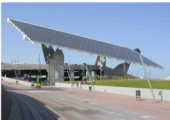
Figura 29 – Central de produção de energia renovável fotovoltaica. Fórum 2004 (Barcelona).
