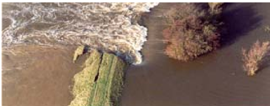
Figura 5 – Dique Van Coc em rotura
