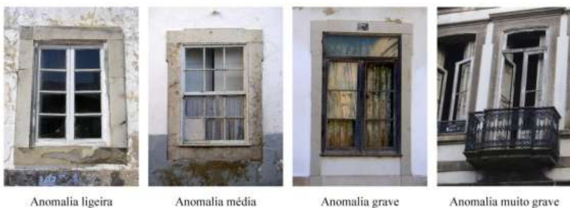
Figura 5 – Fotografias de janelas classificadas segundo nível de anomalia
