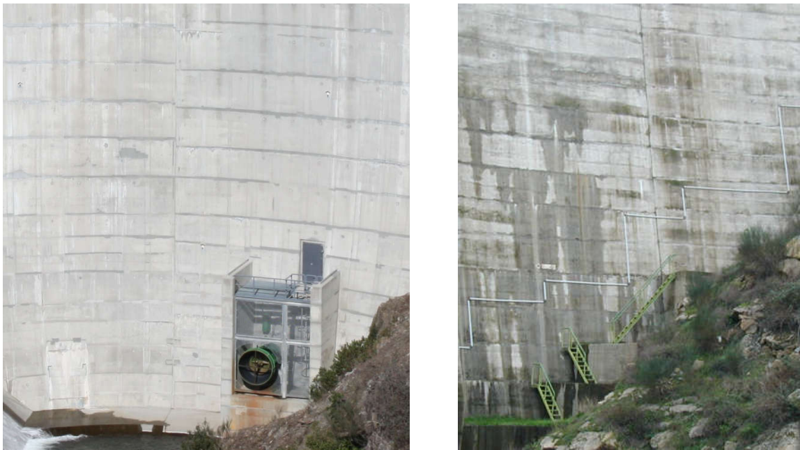
Figura 1. Exemplos de estados aparentes dos paramentos de barragens: betão com aspeto homogéneo e boa ligação entre camadas de betonagem (à esquerda); betão com aspeto menos homogéneo e juntas de betonagem com repasses de água (à direita)
